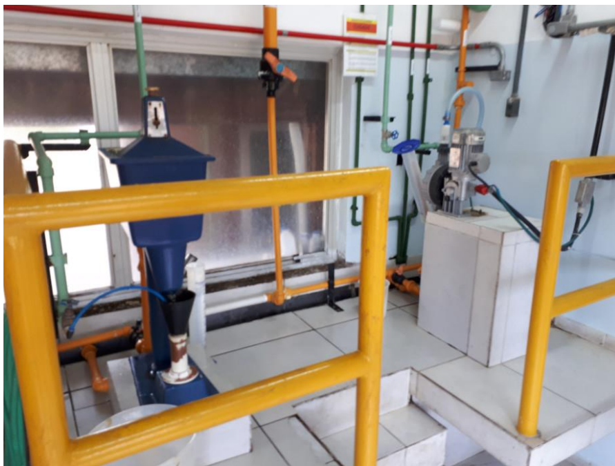
Foto 12 A direita, dosador de nível constante de solução de sulfato de alumínio, a direita, equipamento de dosagem de reserva
