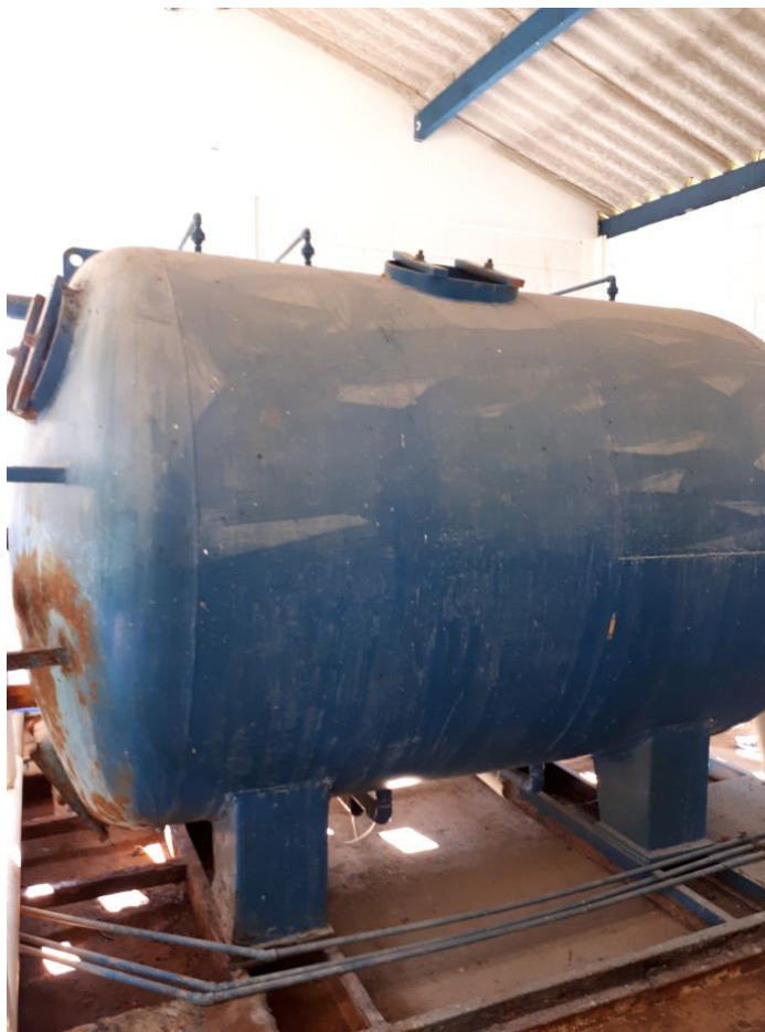
Foto 32 Vista do filtro horizontal sob pressão
