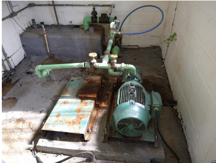
Foto 30 Vista do conjunto motobomba do segundo estágio da captação
