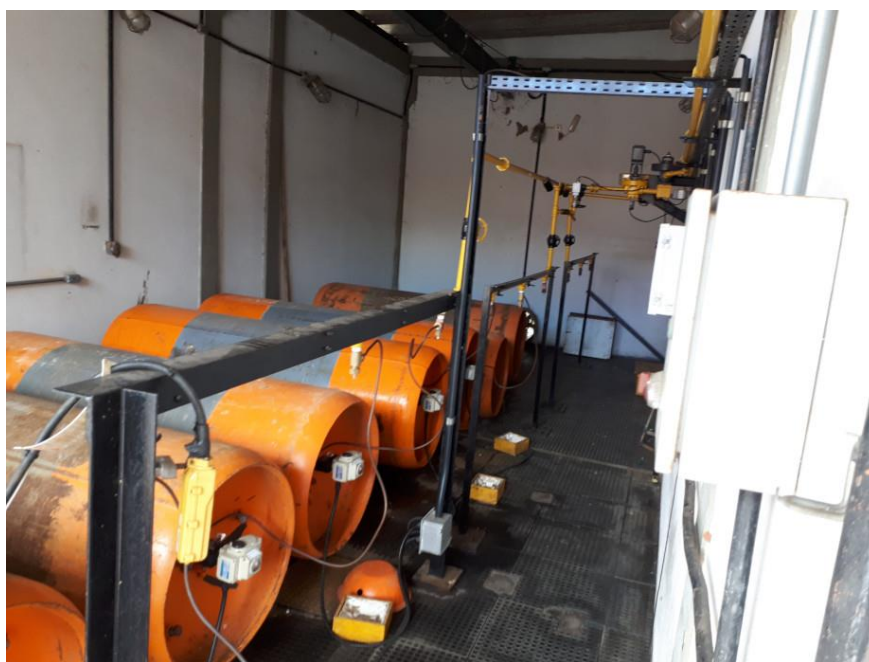
Foto 13 Cilindros de 900 kg para o armazenamento do cloro gasoso
