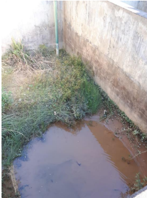
Foto 20 Vista de um dos tanques de armazenamento de efluentes, atualmente desativado
