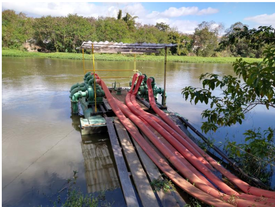
Foto 3 Vista da captação auxiliar flutuante mais antiga e dos mangotes flexíveis de adução até o poço de sucção da captação principal
