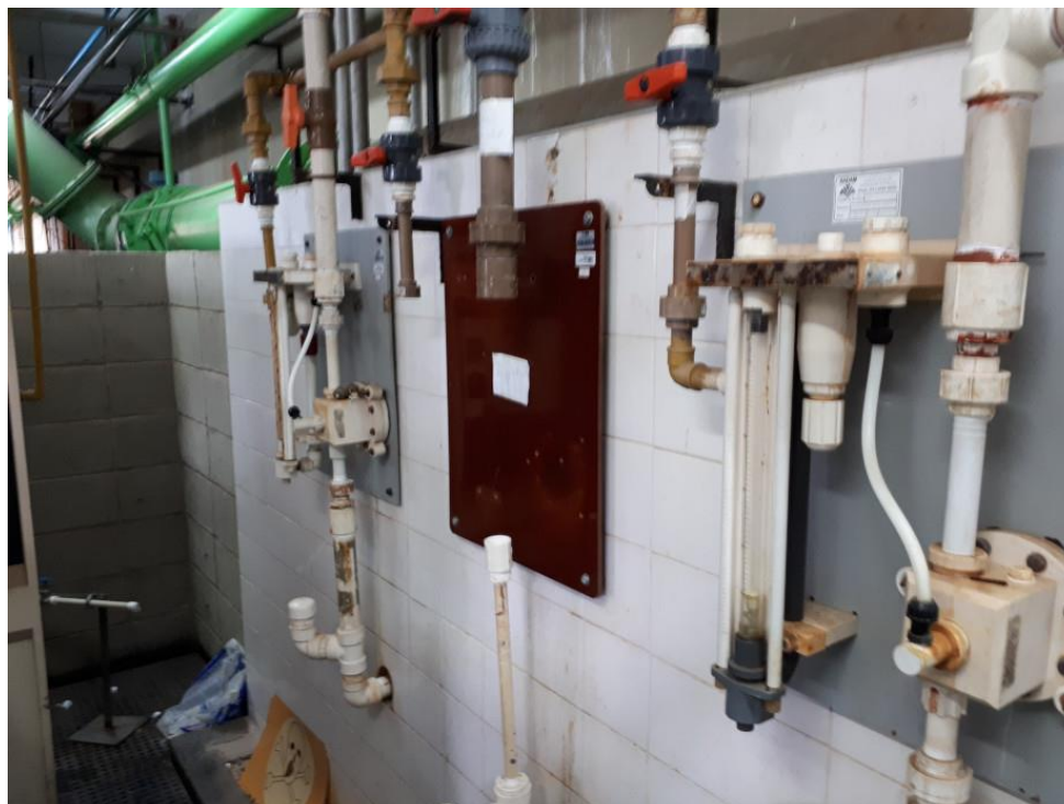
Foto 14 Dosadores de cloro gasoso
