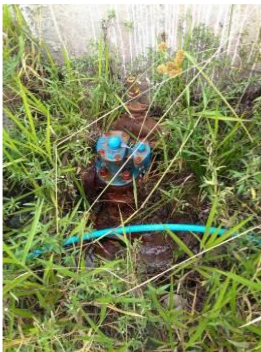
Foto 37 Centro de Reservação Jardim Imperial - Ventosa de distribuição vazando
