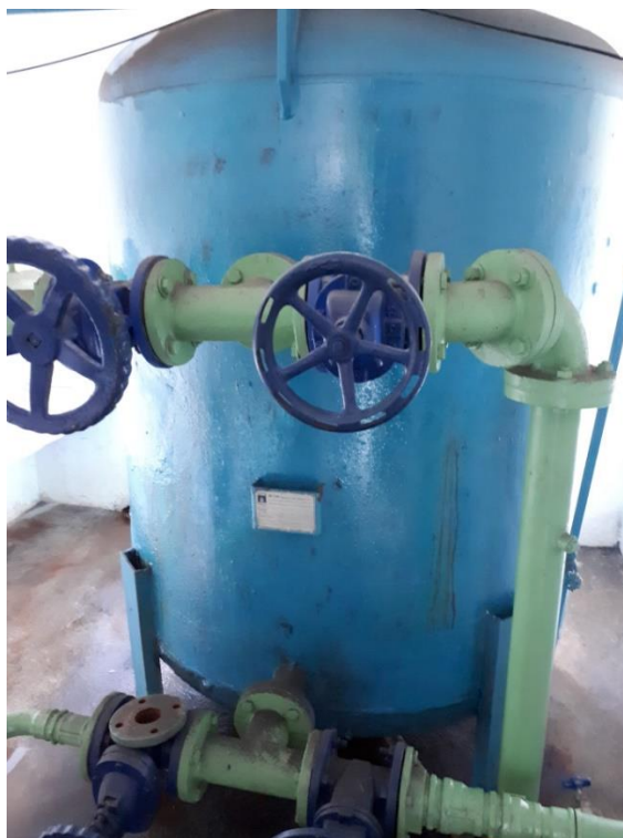
Foto 23 Vista do filtro rápido sobre pressão
