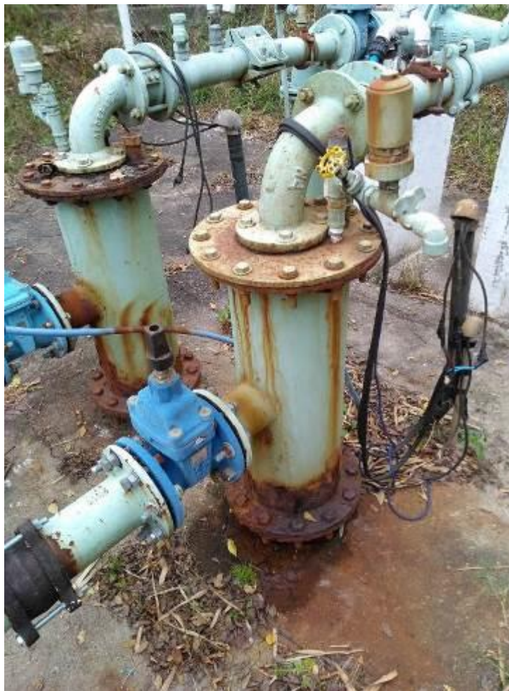
Foto 42 “booster” Jardim Terras de São João - Bombas
