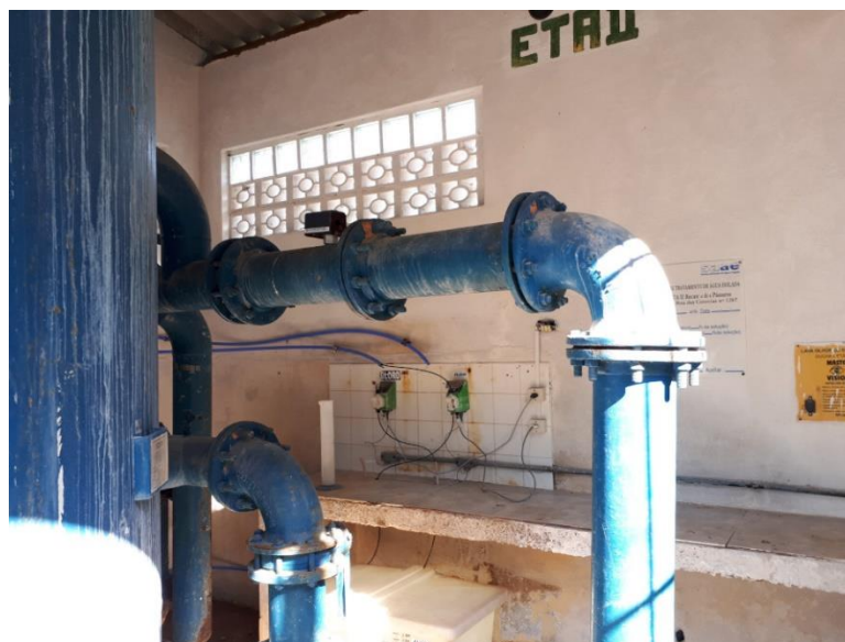
Foto 27 Vista parcial do filtro da ETA II a sistemas de dosagem de hipoclorito de sódio e ácido fluossilícico
