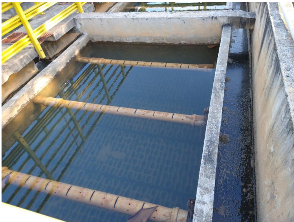
Foto 16 Decantador de alta taxa com destaque para os módulos lamelares submersos e as tubulações perfiradas de coleta de água decantada
