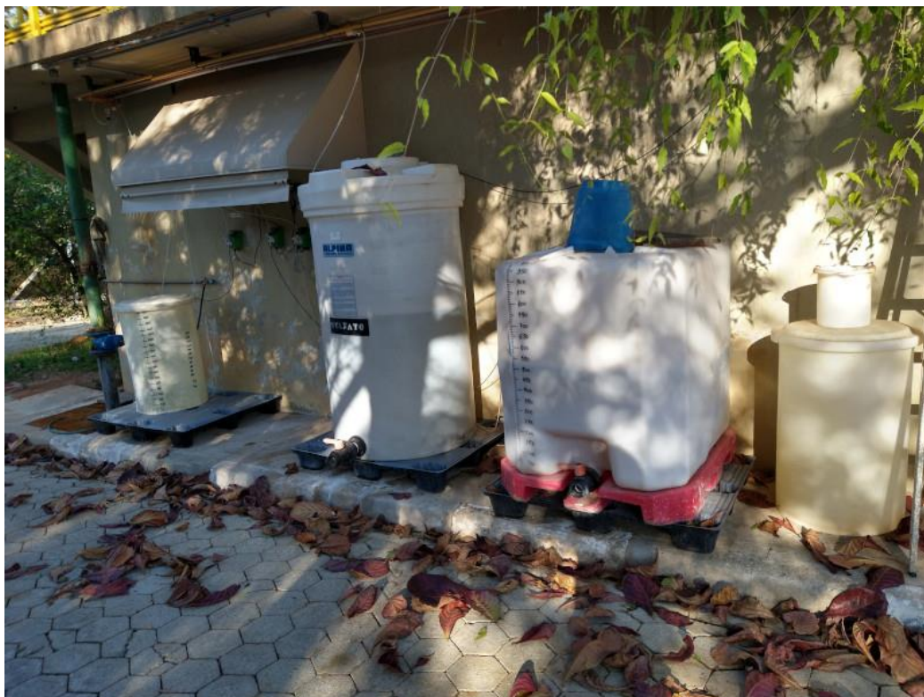
Foto 18 Vista geral dos sistemas de armazenamento e dosagem de produtos químicos: sulfato de alumínio, hipoclorito de sódio e ácido fluossilícico
