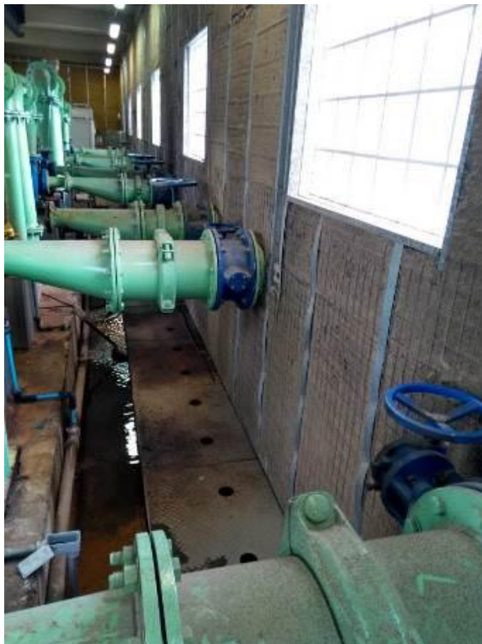
Foto 40 EEA Diogo Fontes - Registros de manobra emperrados
