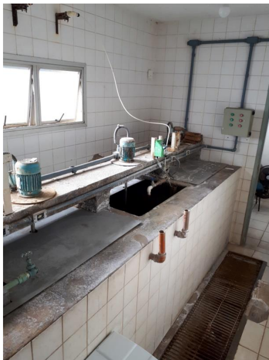
Foto 19 Sala de preparo e dosagem de barrilha
