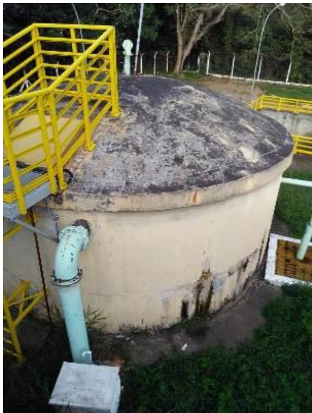
Foto 34 ETA São Silvestre - Reservatório apoiado de passagem
