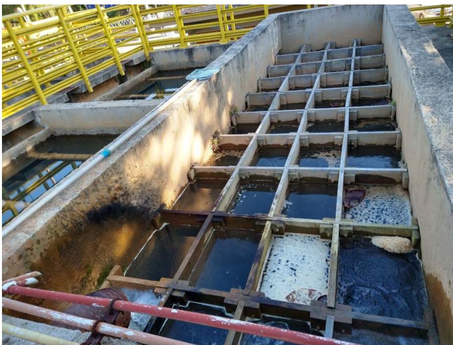
Foto 15 Vista geral dos flocladores hidráulicos, à direita, e decantadores, à esquerda
