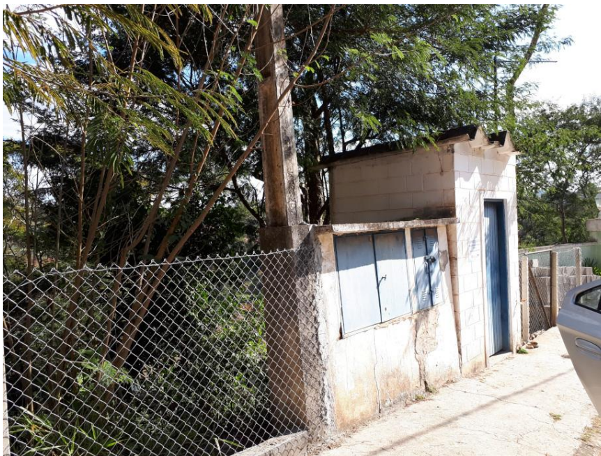
Foto 25 Vista geral do nicho de abrigo do painel de energização e acionamento das motobombas da captação da ETA II
