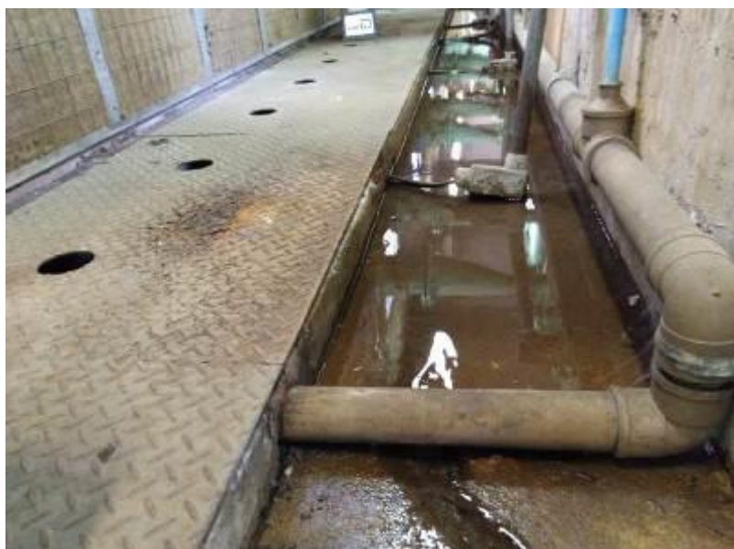
Foto 39 EEA Diogo Fontes - Calha de cabos elétricos (440V) junto à calha de esgotamento de água
