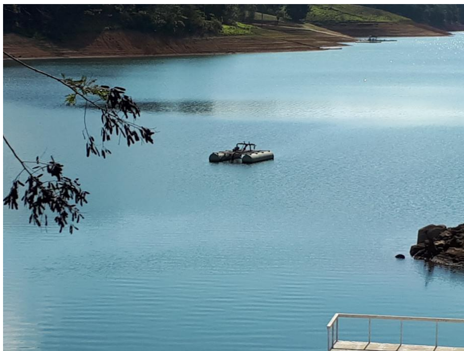
Foto 29 Vista da captação flutuante, primeiro estágio de recalque
