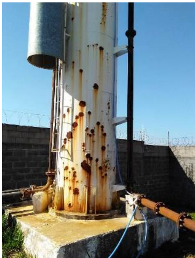
Foto 36 Centro de Reservação Jardim Paraíso - R73
