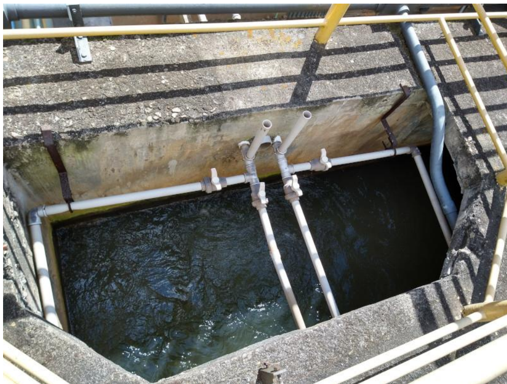
Foto 6 Vista da estrutura de chegada de água bruta e tubulações de aplicação de produtos químicos
