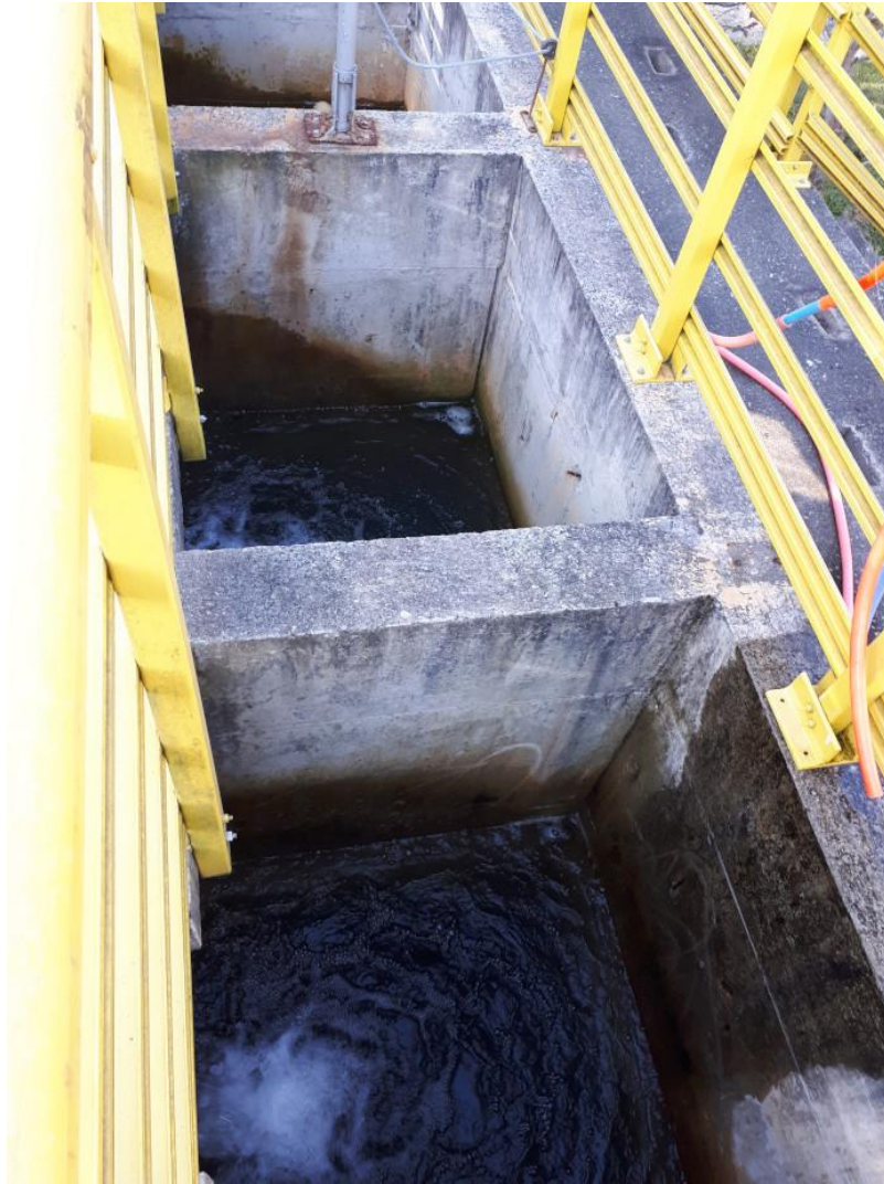
Foto 17 Vista geral dos filtros
