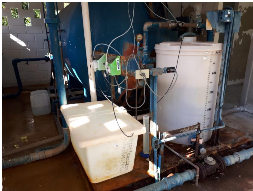
Foto 33 Vista do filtro horizontal sob pressão e, em primeiro plano, sistemas de armazenamento e dosagem de hipoclorito de sódio e ácido fluossilícico
