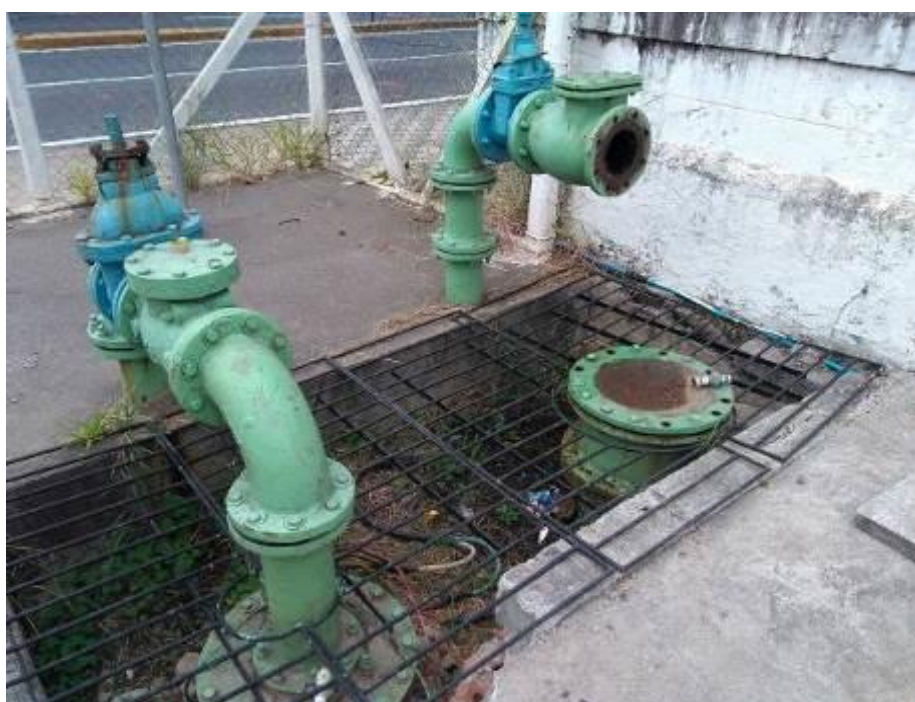
Foto 41 “booster” B2 da Praça Independência para Jardim Panorama (R08) - Bombas
