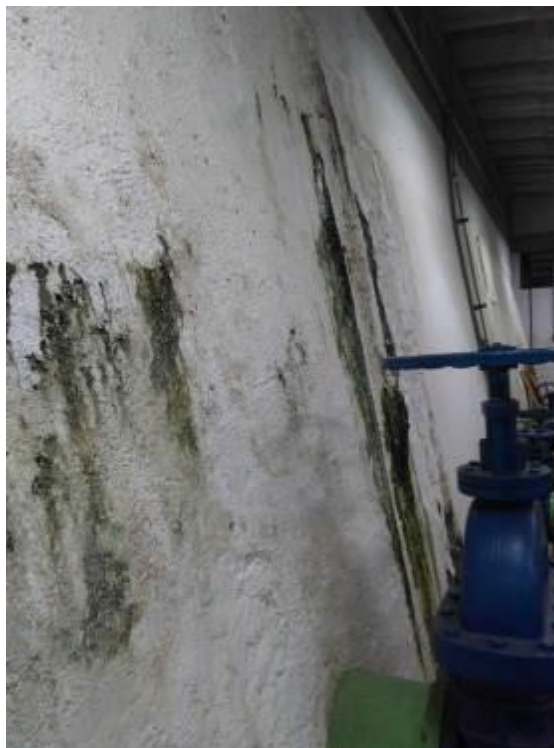
Foto 35 ETA Central - Patologia estrutural na parede do reservatório 05
