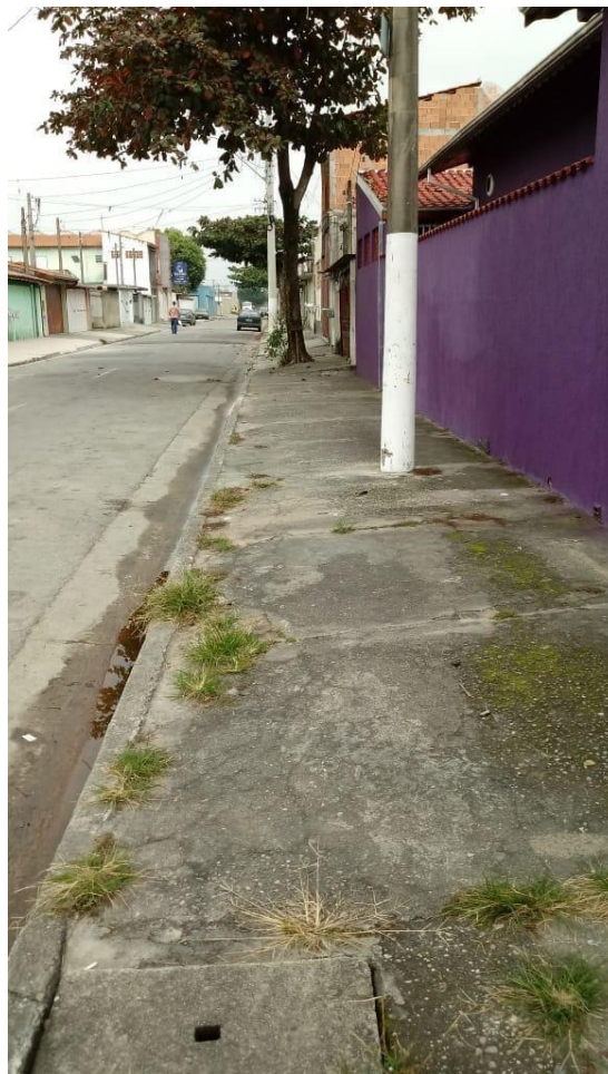
Calçada larga, com árvore antiga na faixa de circulação e poste distante da guia (faixa de serviço).
