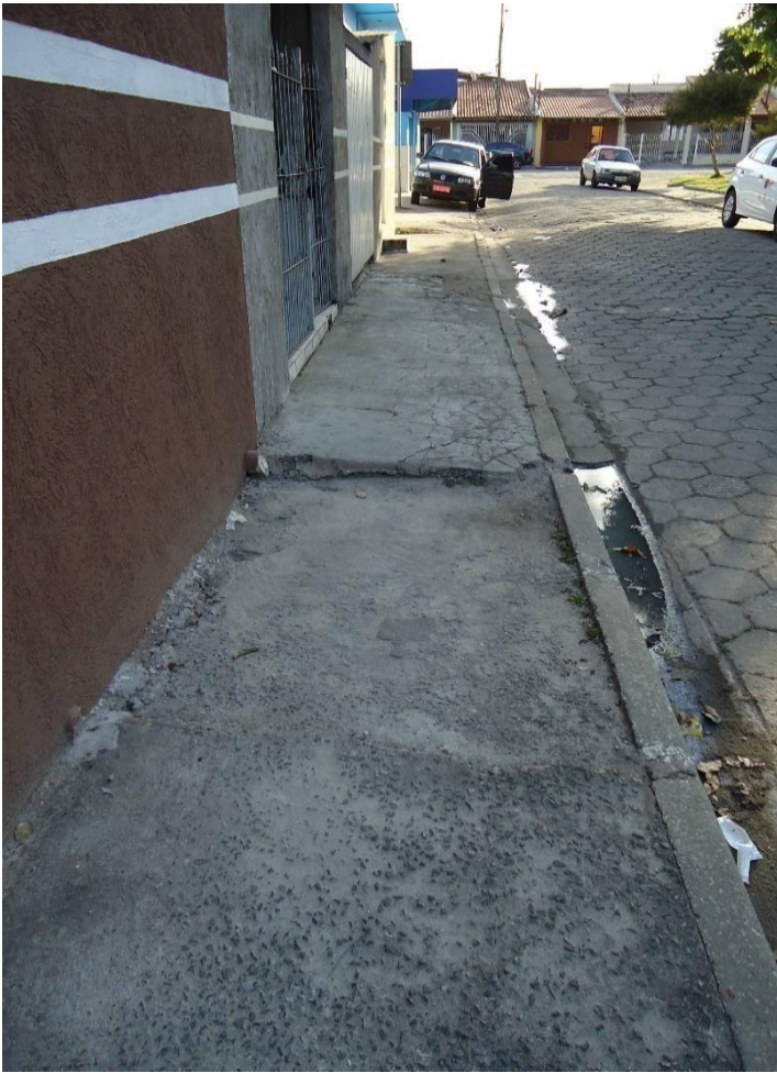
Calçada em cimento, com falta de manutenção, sem obstrução.
