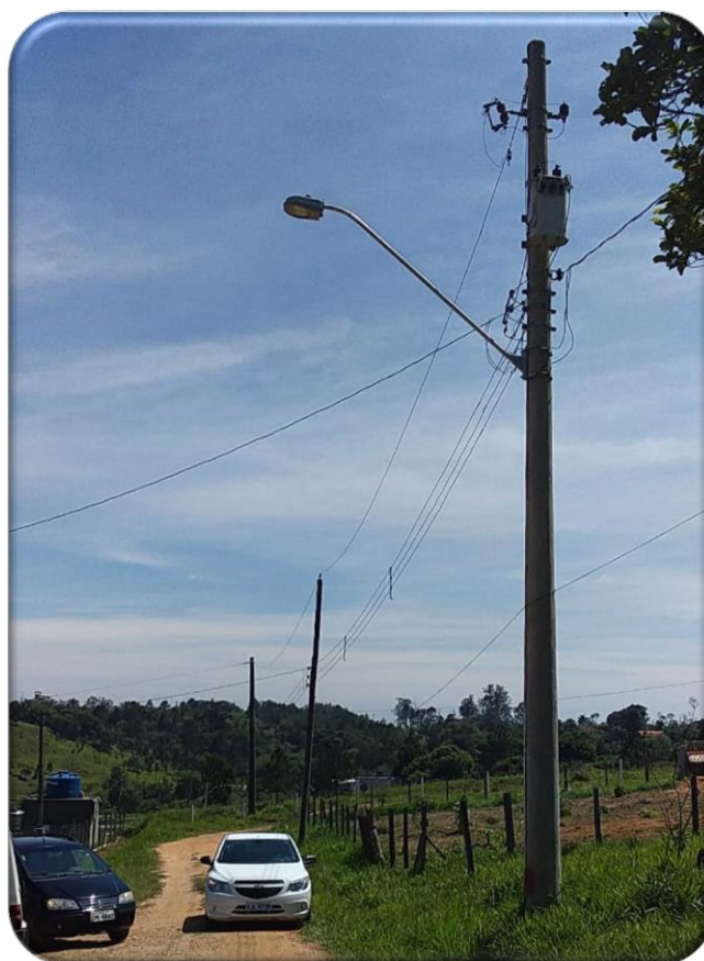
Figura 15: Poste identificado pela diligência onde foi instalado o 4° kit.
