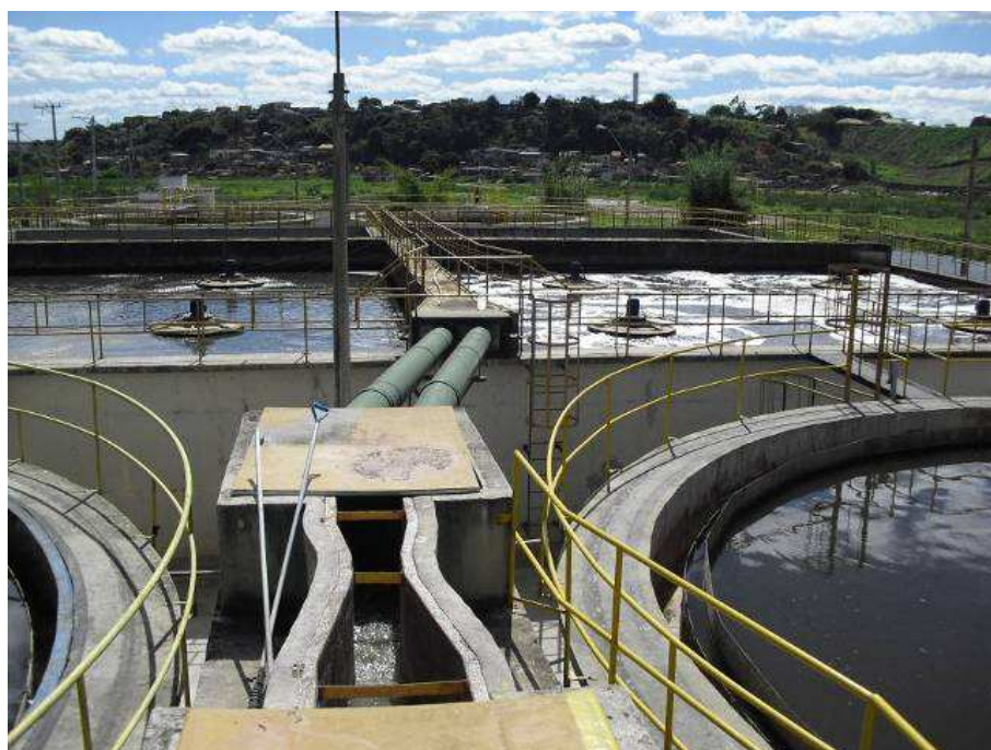
Foto 36 – Decantador e tanque de aeração da ETE Vila Branca.
