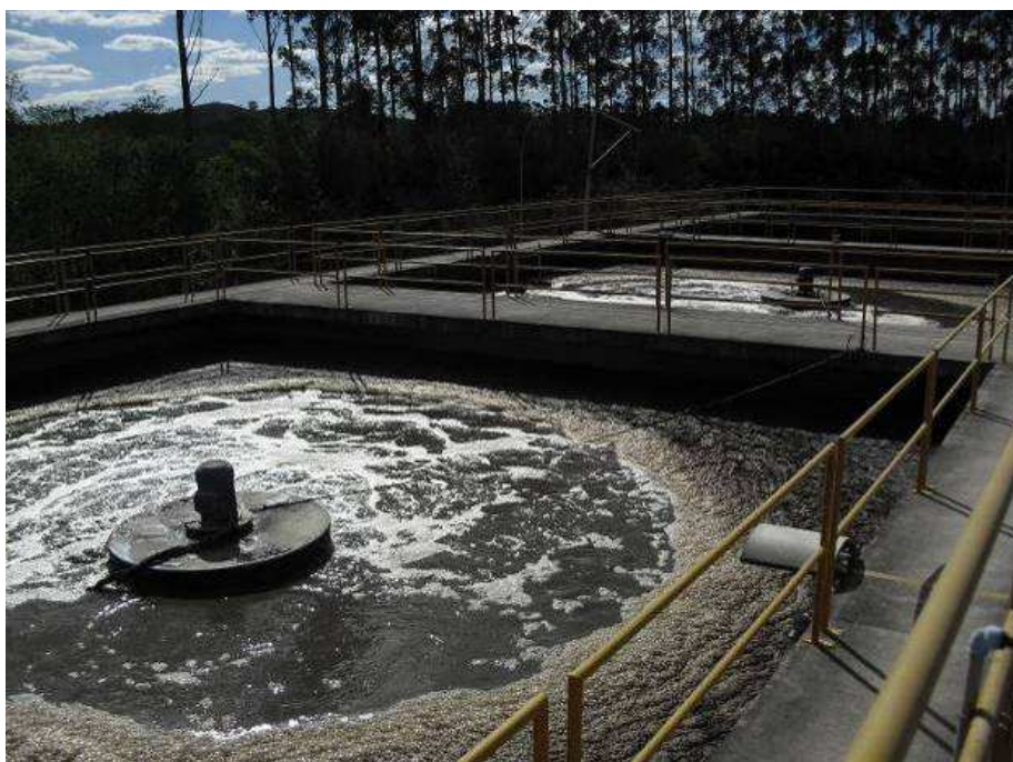
Foto 33 – Tanque de aeração da ETE Meia Lua.
