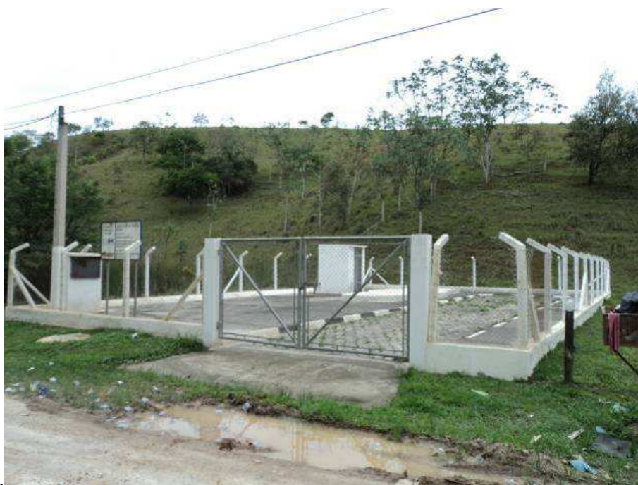
Foto 27 – Estação Elevatória EEE 34 – Bandeira Branca.
