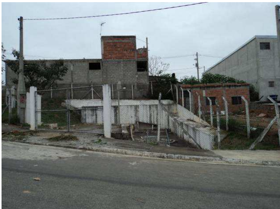
Foto 25 – Estação Elevatória de Esgotos – EEE 31 – Santa Paula.
