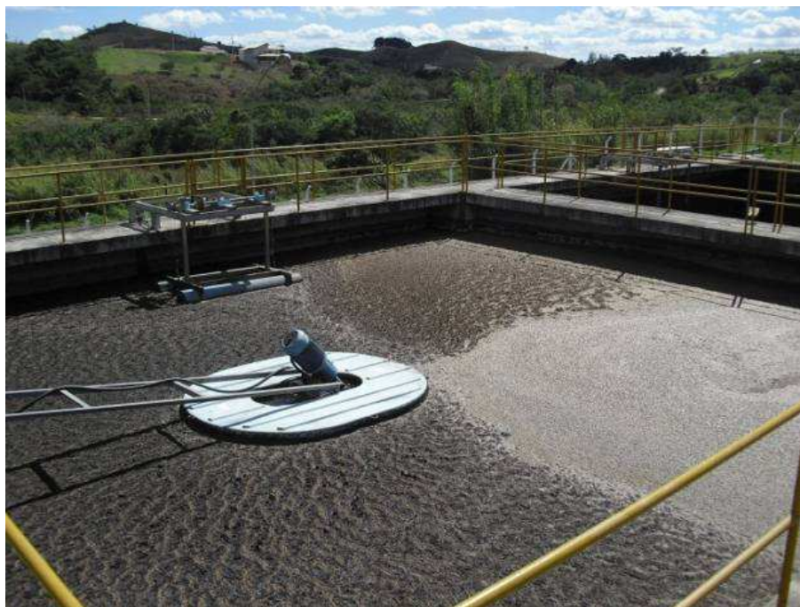
Foto 29 – Tanque de aeração da ETE Bandeira Branca.
