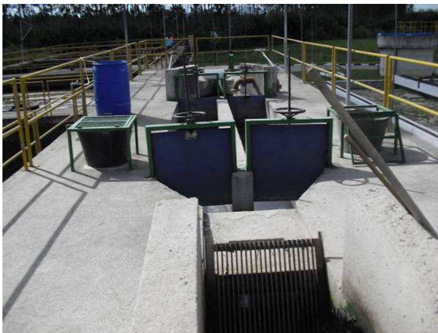
Foto 32 – Tratamento preliminar da ETE Meia Lua.
