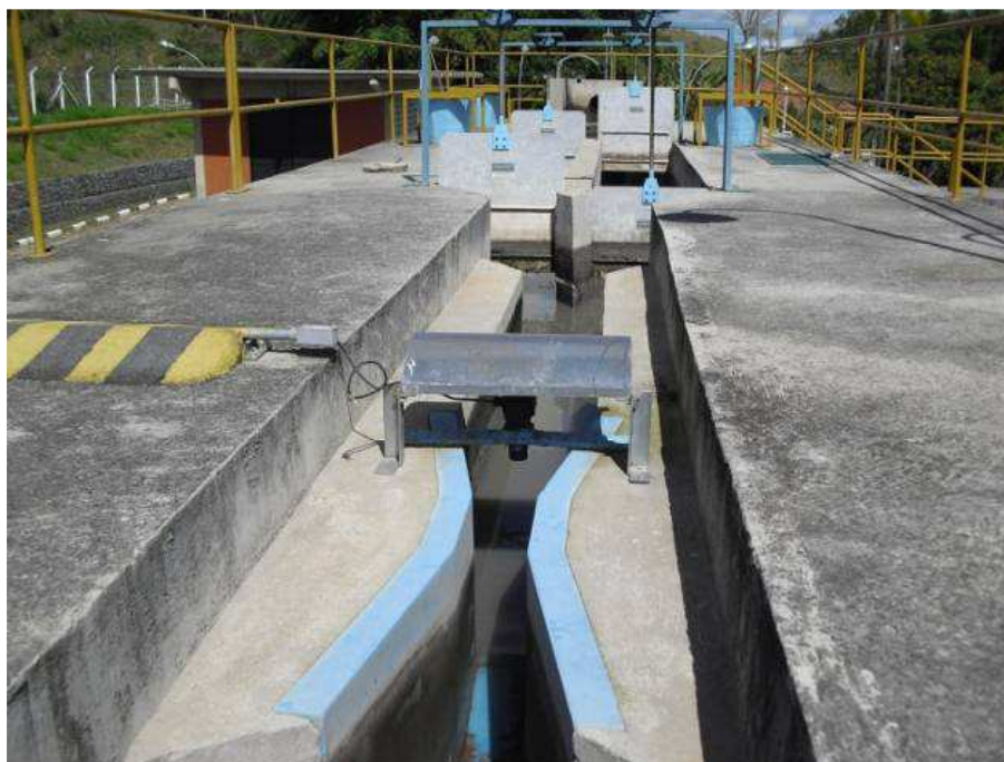
Foto 28 – Chegada de esgoto na ETE Bandeira Branca.
