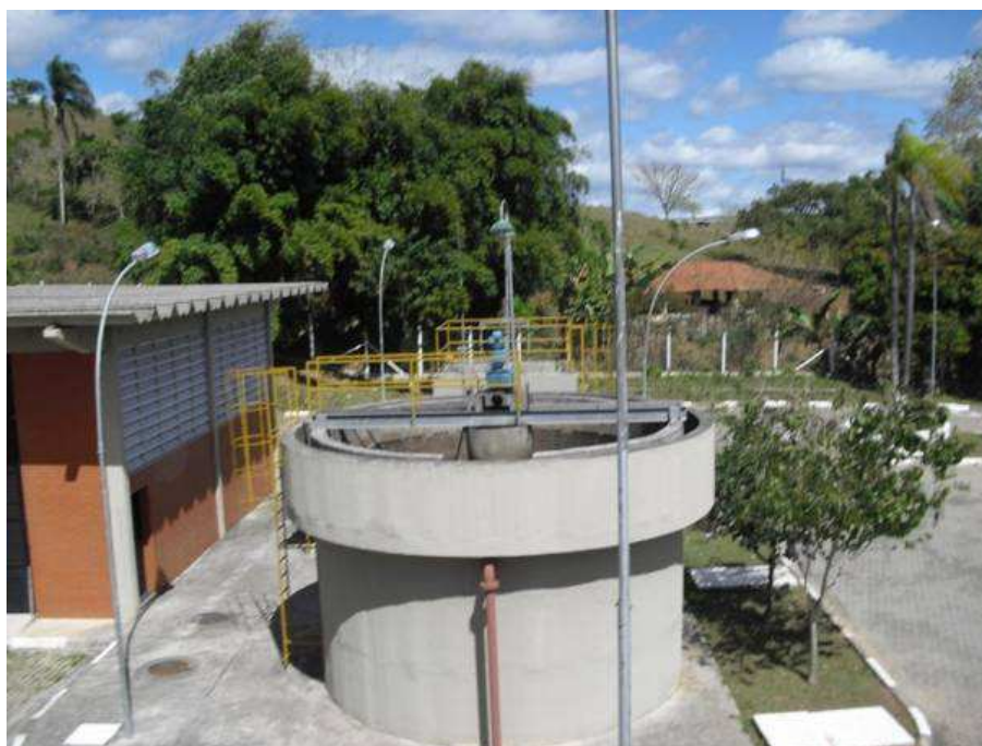
Foto 30 – Tanque de adensamento de lodo da ETE Bandeira Branca.
