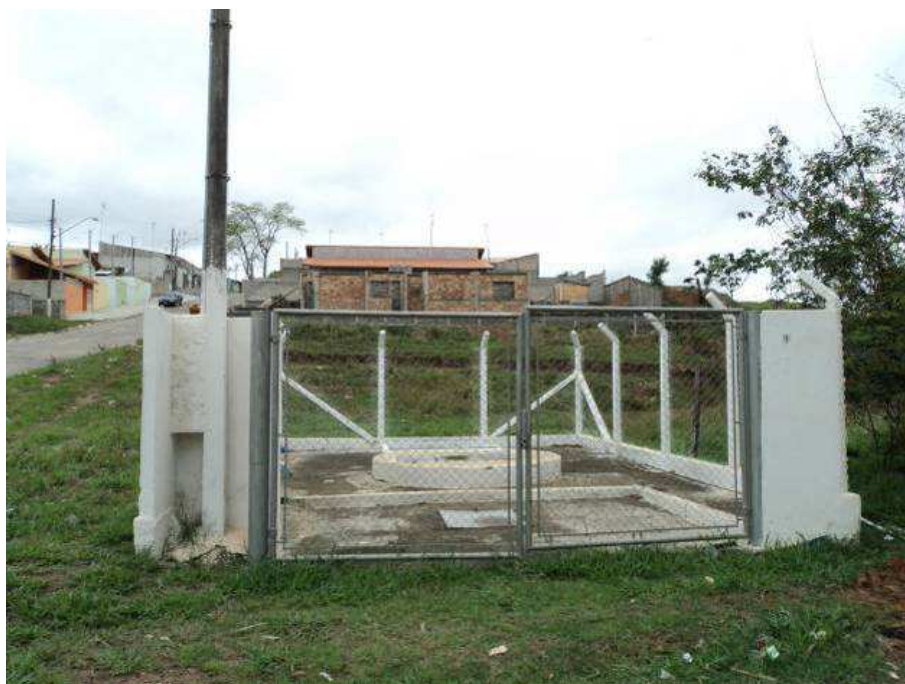
Foto 17 – Estação Elevatória de Esgotos EEE 5.
