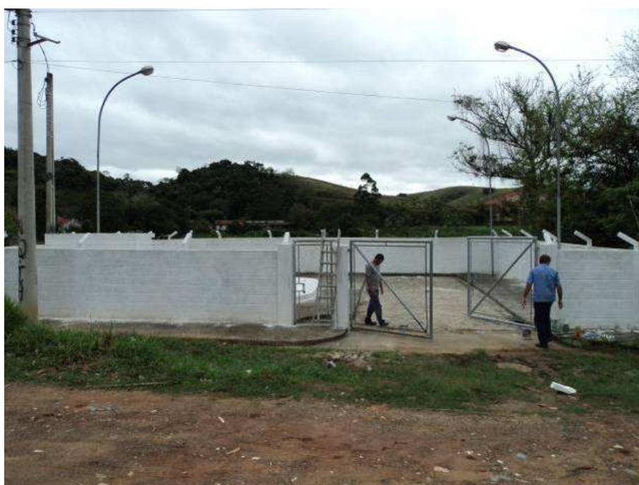
Foto 18 – Estação Elevatória de Esgotos EEE 26.
