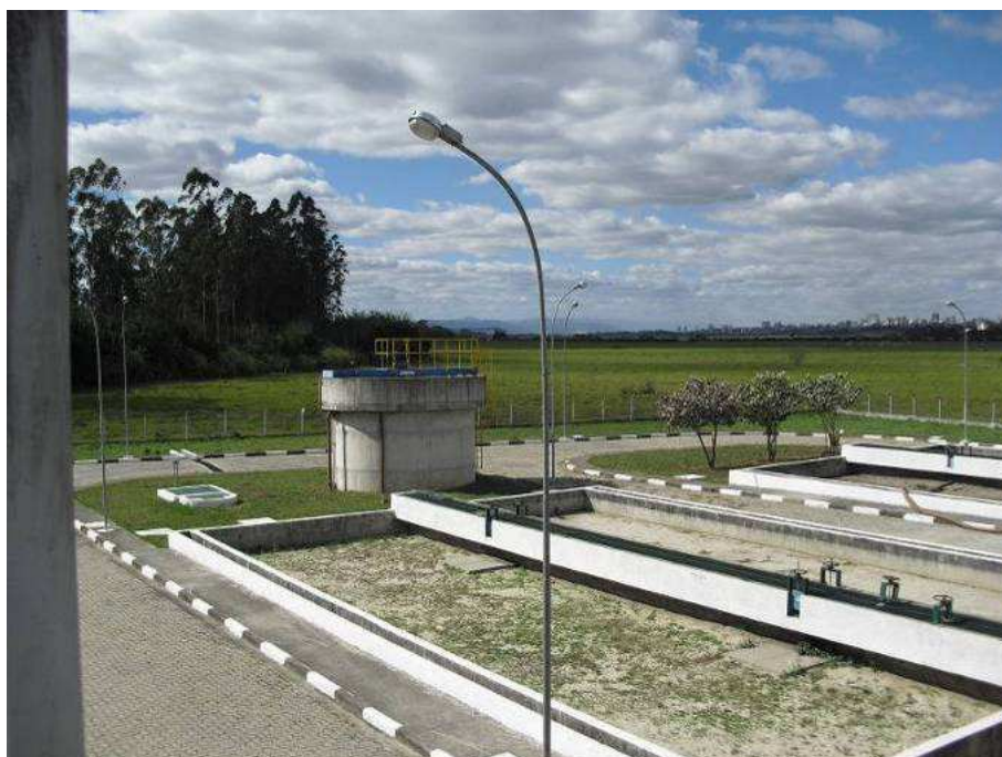
Foto 34 – Tanque de adensamento de lodo e leito de secagem da ETE Meia Lua.
