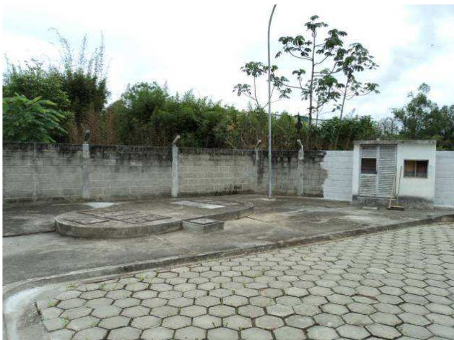
Foto 19 – Estação Elevatória de Esgotos EEE 27.
