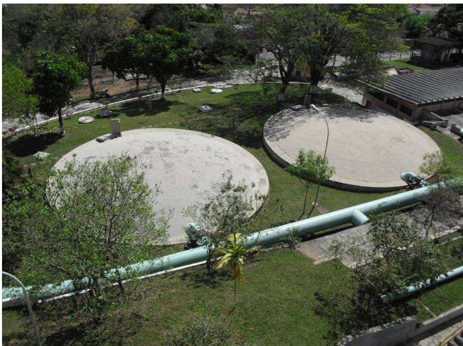
Foto 06 – Reservatórios de água tratada – ETA Central.
