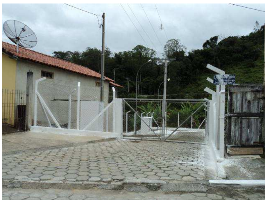
Foto 20 – Estação Elevatória de Esgotos EEE 28.
