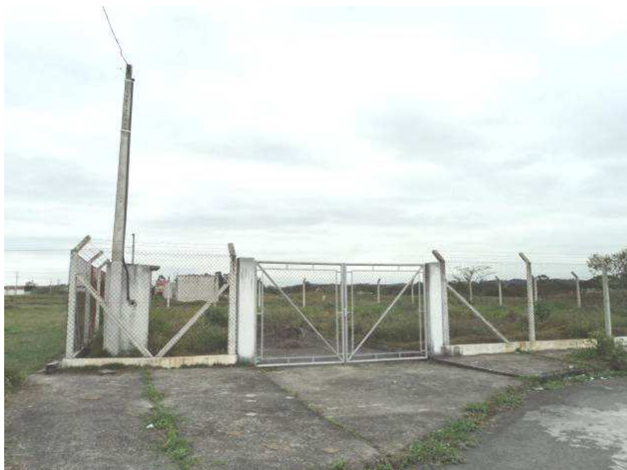
Foto 24 – Estação Elevatória de Esgotos – EEE Parque dos Sinos.
