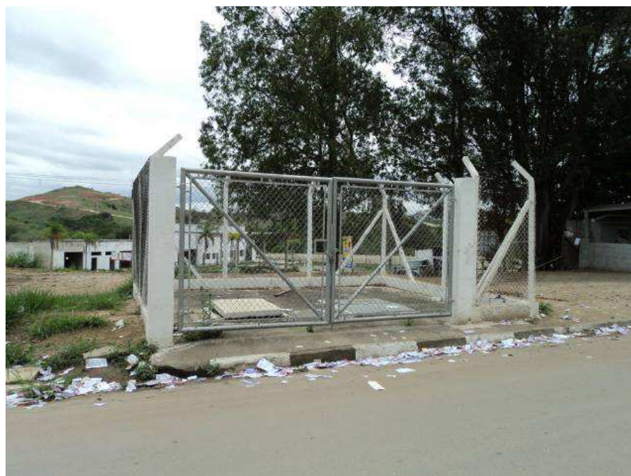
Foto 16 – Estação Elevatória de Esgotos EEE CDHU.
