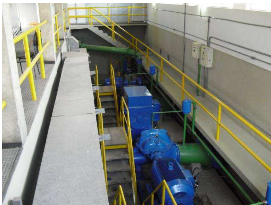
Foto 03 – Estação Elevatória de Água Bruta.
